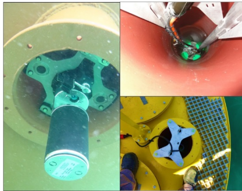
Intégration de l'instrumentation dans des puits
